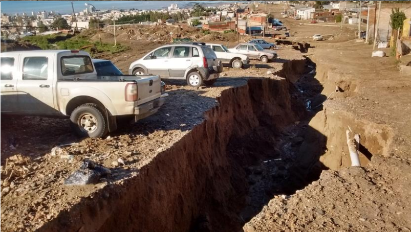
Cárcava en el faldeo Sur del cerro Chenque en las calles Patagonia esquina Formosa en el barrio Pietrobelli.
