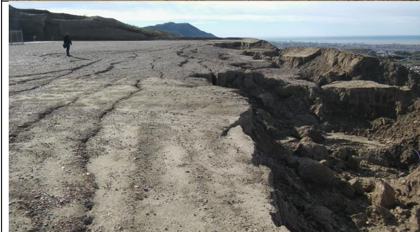
Cárcava con deslizamiento del borde de talud occidental en locación de pozo petrolero cercano a la rotonda del camino Roque González. (Vista al Norte) en el cerro Arenales.
