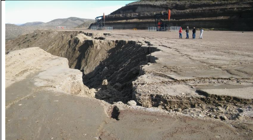
Cárcava con deslizamiento del borde de talud occidental en locación de pozo petrolero cercano a la rotonda del camino Roque González. (Vista al Sur) en el cerro Arenales.
