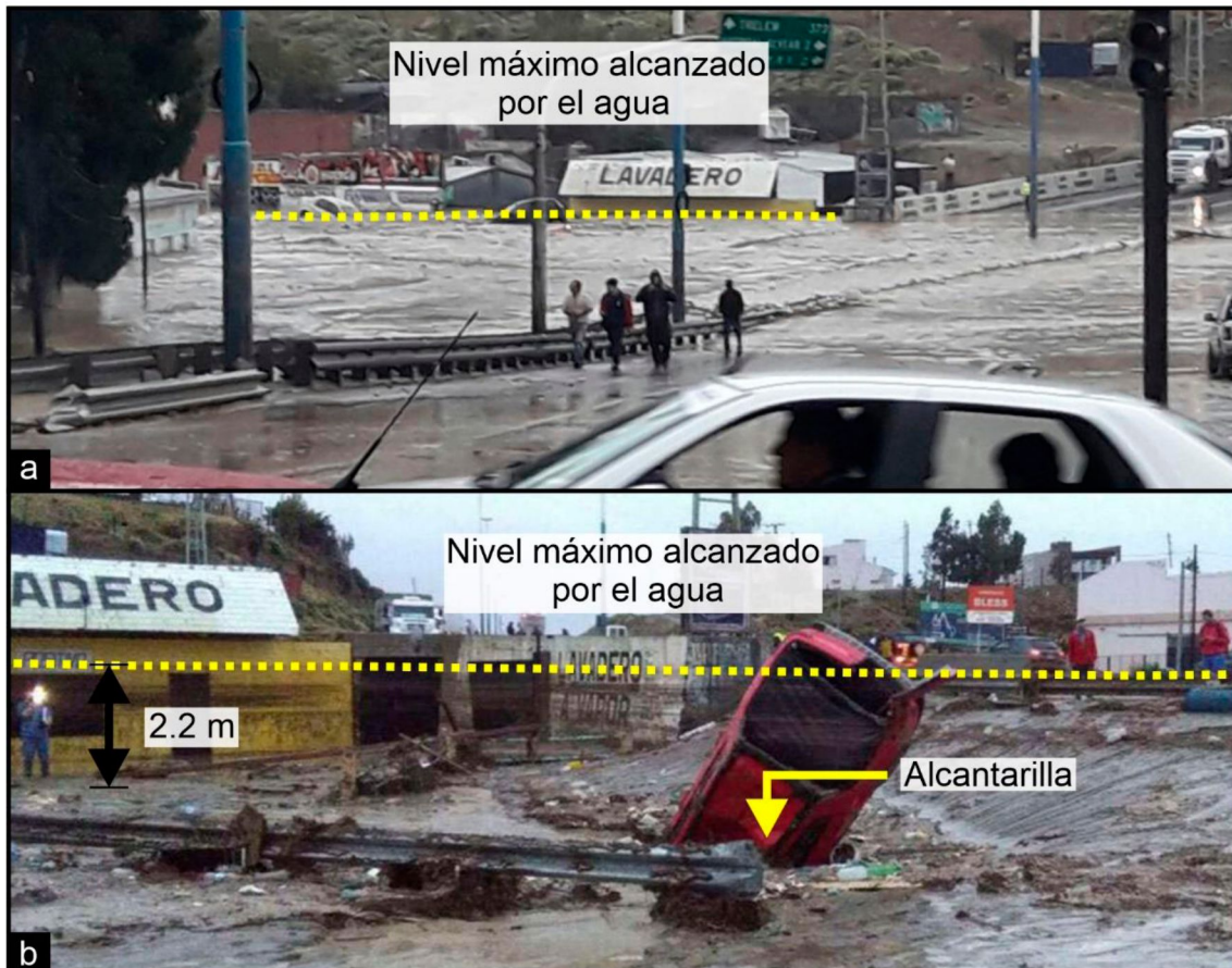
Figura 11. Estado de la boca del pluvial próximo a Ruta Nacional N° 3. a) Fotografía tomada al momento del máximo nivel alcanzado por el agua. b) Alcantarilla obstruida parcialmente por un vehículo que fuera arrastrado durante la tormenta. Puede observarse el nivel máximo alcanzado por el agua (2.2 m).
