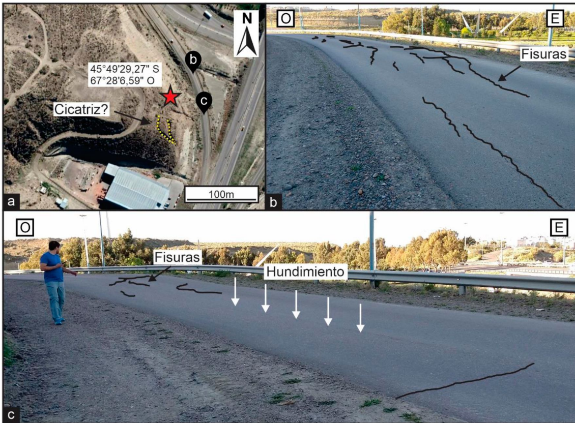
Figura 33. a) Deslizamiento de Km. 4. b y c) Fisuras y hundimientos del pavimento.
