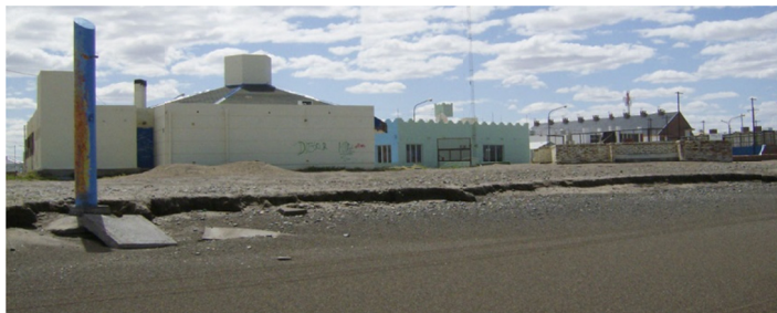
Figura 18: escarpe de erosión en primer plano; se puede apreciar la destrucción de una estructura; en el fondo se observan inmuebles del municipio de Rawson, arreglo 5H.
