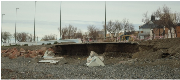
Figura 25: erosión marina en el arreglo 7F en el corte 2012. (Foto: agosto 2013)
