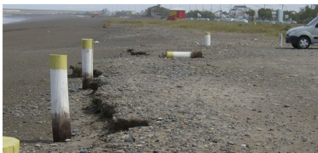
Figura 28: escarpe de erosión en una playa de estacionamiento/área recreativa. Arreglo 11A.
