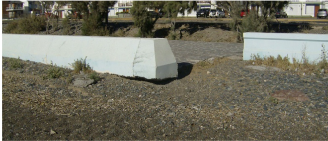
Figura 22: se observa un tramo del murete con la base destruida por socavamiento. Arreglo 7F
