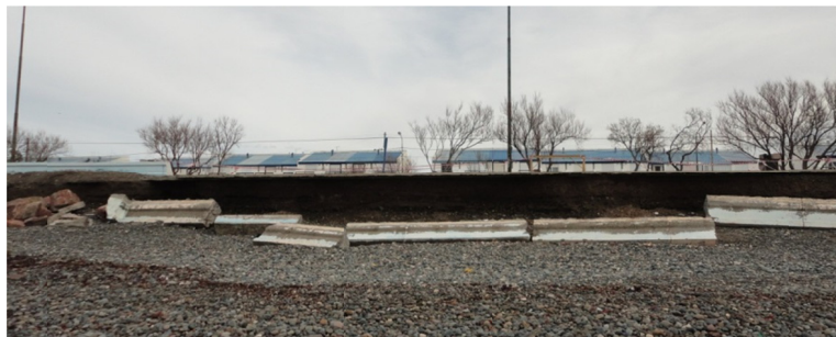
Figura 24: murete colapsado debido a la erosión costera. Arreglo 7F(2012). (Foto: agosto 2013)
