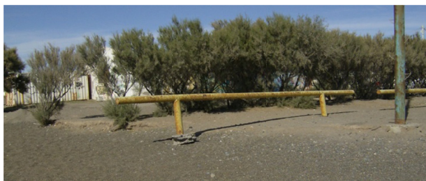
Figura 27: escarpe de erosión y estructuras expuestas por la erosión costera. Arreglo 10A.
