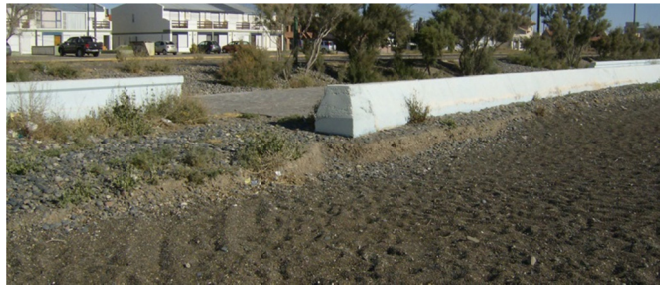
Figura 21: escarpe de erosión contiguo al murete. Arreglo 7F.
