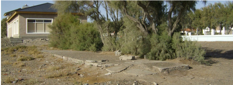
Figura 20: edificio del restaurante “Bogavante” y otra estructura, ya deteriorada, expuestas a la acción de procesos erosivos. Arreglo 9C.
