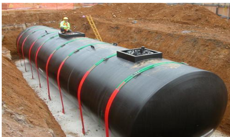
Foto 3. Tanque de almacenamiento de combustible subterráneo. Fuente: Surtidores, 2020.
