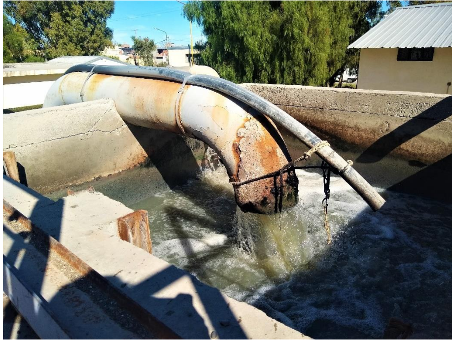
Foto 5: Ingreso de afluente en planta.
