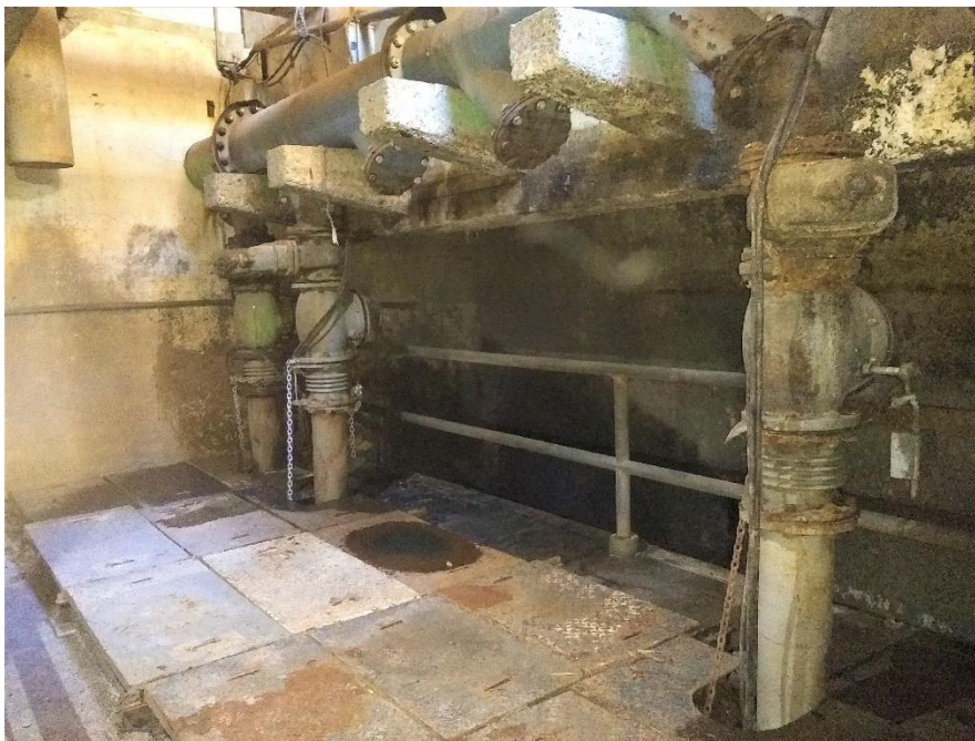
Foto 4: Sistema de bombeo. Estación Vucetich.
