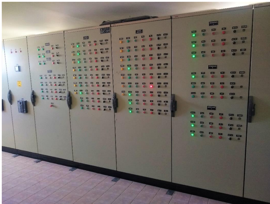
Foto 6: Tablero de control. Planta.
