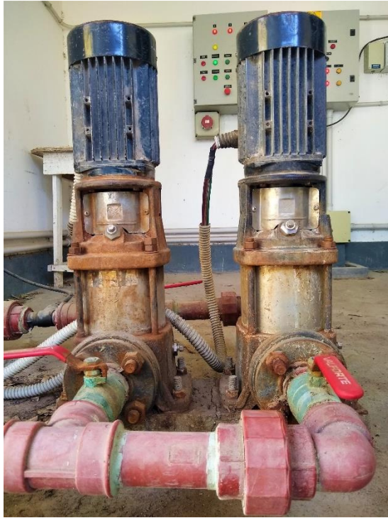
Foto 7: Bombas de cloración. Planta.
