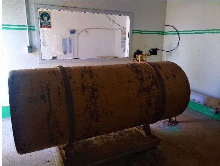
Figura 14: Tubo de gas cloro. Sala de cloración.
