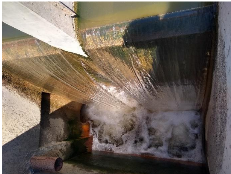
Figura 15: Salida de efluente desinfectado.
